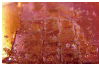
全体的に剥離が確認できる。
